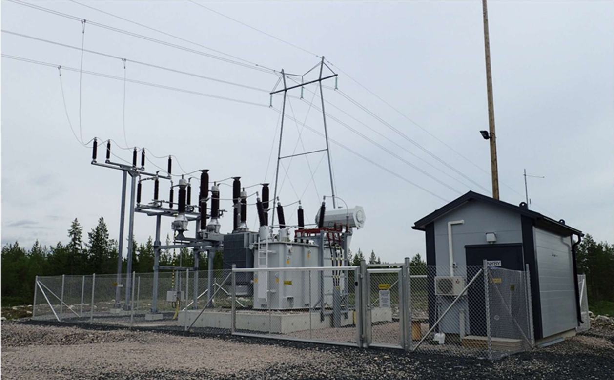
Kuva 71. Esimerkki tuulivoimapuiston sähköasemasta (kuva: FCG).
